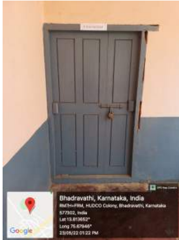
E-waste disposal room
